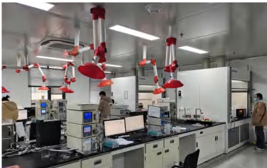
废气收集系统（封闭式实验室+集气罩/通风橱+两级 25m 高排气筒）
