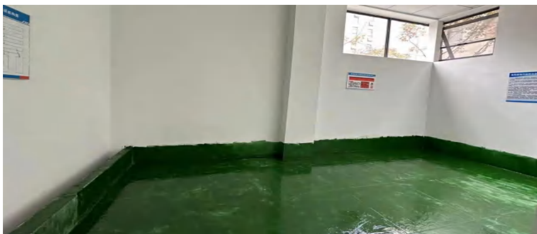
危废仓库（标识+围堰+防渗漏托盘）
