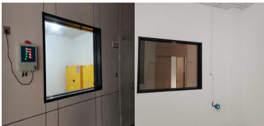
化学品库（可燃气体报警器+防爆柜+消防系统+监控系统）
