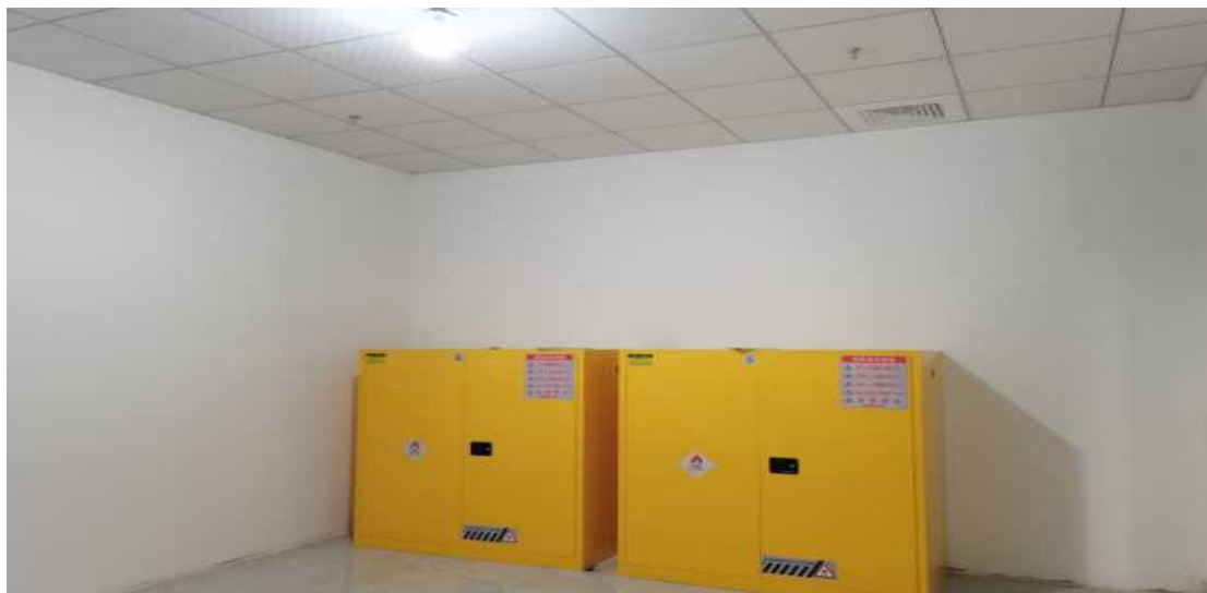
化学品库（可燃气体报警器+防爆柜+消防系统+监控系统）
