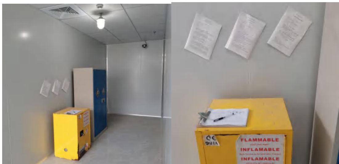
易制毒易制爆化学品仓库（防爆柜、消防、监控系统）
