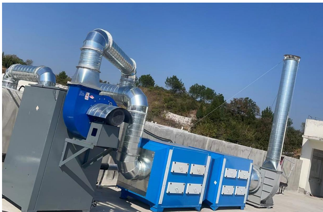
墨水调配废气（粉尘、非甲烷总烃）经除尘器预处理除尘后与注塑有机废气（非甲烷总烃）一起汇集进入两级活性炭吸附装置处理后通过1根15m高排气筒（DA001）有组织排放
