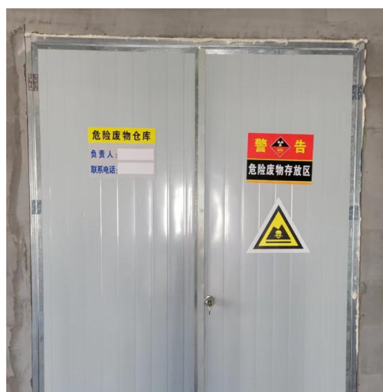
危废仓库（围堰、标识、防腐防渗地坪）
