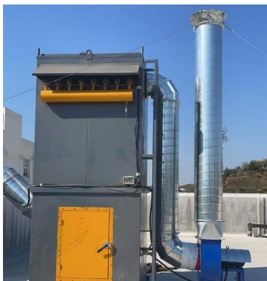
破碎工序配套除尘器
