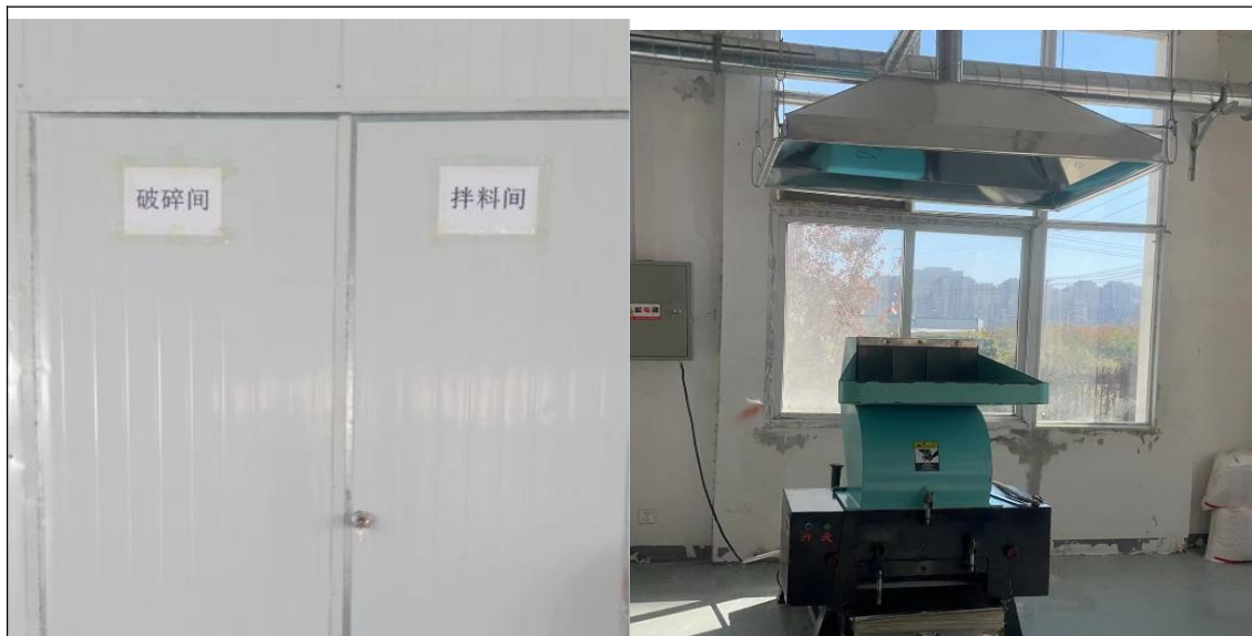
破碎房+集气罩+布袋除尘器+排气筒（DA002）有组织排放
