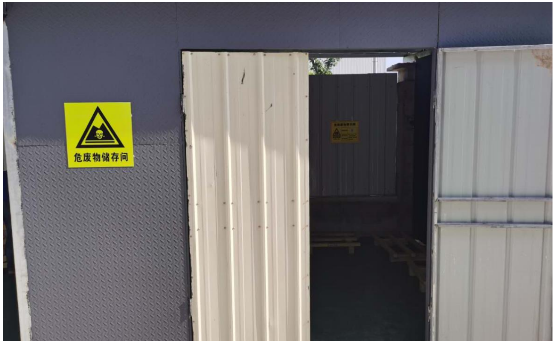
危废暂存库（标识、内部设置导流槽及集液铁桶）
