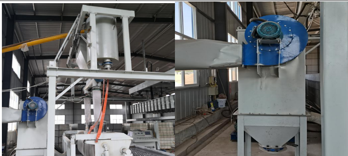
全自动密闭生产线+布袋除尘器
